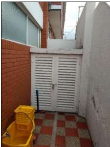
Ilustración 135. Cuarto de almacenamiento De residuos sin señalización U.S. Mochuelo.
