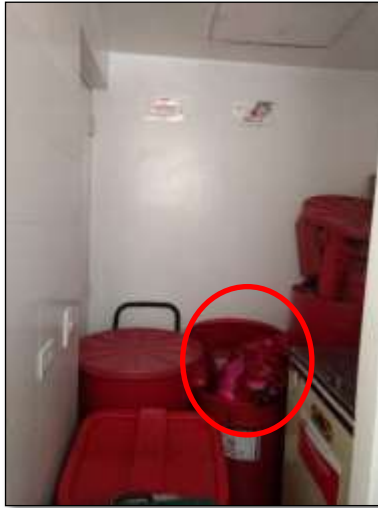
Ilustración 160. Almacenamiento de residuos químicos y biosanitarios sin separación física U.S Candelaria I
