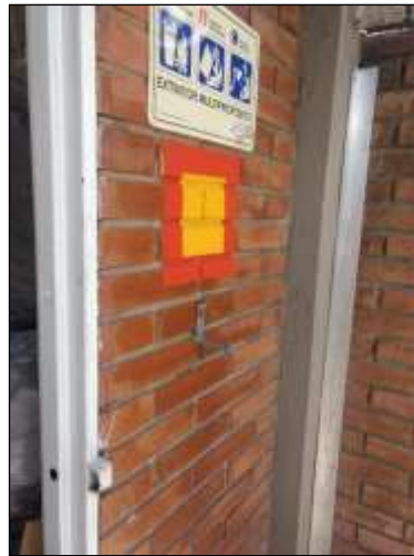
Ilustración 159. No hay extintor U.S San Francisco
