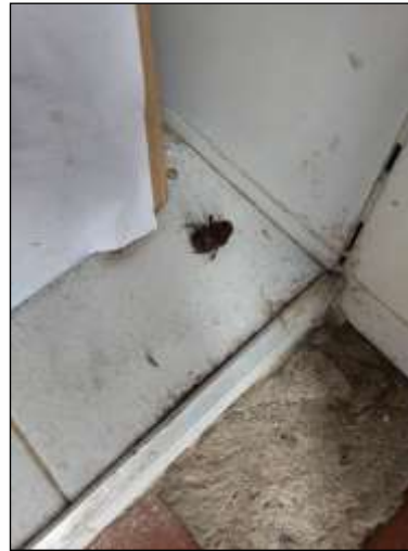
Ilustración 142. Presencia de vectores en cuarto de almacenamiento, no cuenta con media caña U.S. Destino
