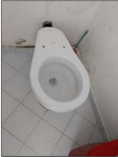
Ilustración 21. Fuga en inodoro hospitalización sexto piso US Meissen.
