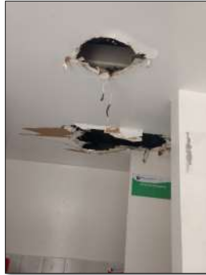
Ilustración 177. Techo dañado U.S. Sierra Morena.
