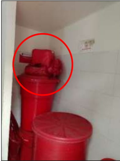
Ilustración 173. Residuos químicos y biosanitarios almacenados sin separación física U.S. Manuela Beltrán.
