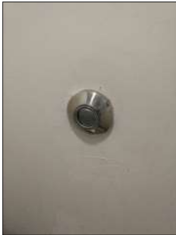
Ilustración 23. Sistema push dañado Fuga en hospitalización U.S. Meissen
