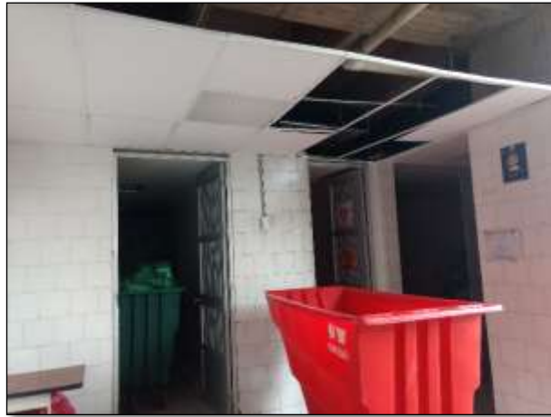
Ilustración 127. Cuarto de almacenamiento de residuos no peligrosos no cuenta con señalización.
