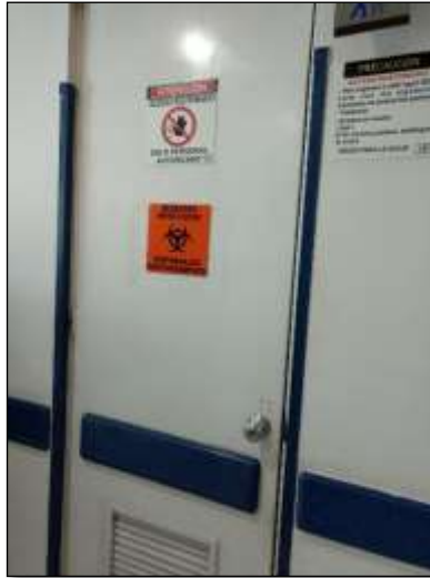
Ilustración 120. Señalización de cuarto de almacenamiento con información Incompleta.
