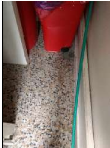
Ilustración 184. Paredes sin media caña U.S. San Isidro
