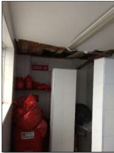
Ilustración 139. Techo dañado, posible Afectación por lluvias e ingreso de Vectores. U.S Destino.
