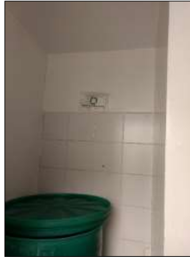
Ilustración 161. Señalización interna no permite limpieza y desinfección U.S Candelaria I
