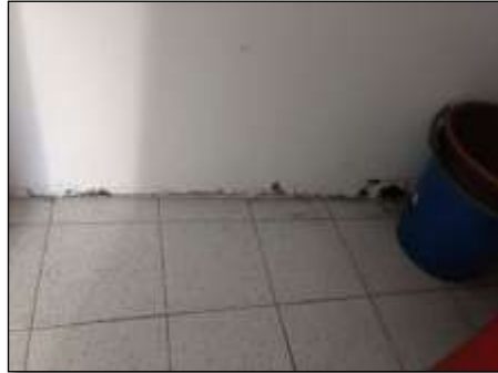
Ilustración 153. Pintura en las paredes Levantada U.S Casa de Teja.
