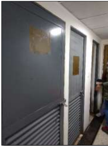
Ilustración 130. No se evidencia Señalización Cuartos de residuos U.S. San Juan
