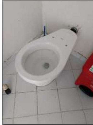
Ilustración 22. Fuga en inodoro hospitalización quinto piso US Meissen
