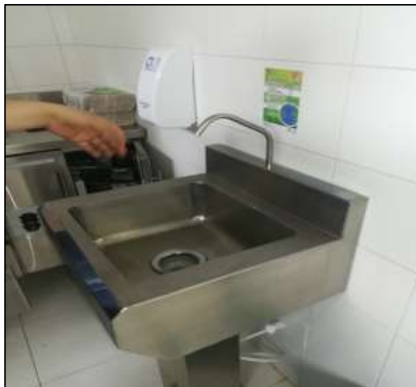
Ilustración 14. Lavamanos de difícil cierre
