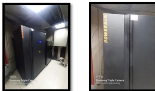
Imagen 33: Fotografías Manteniendo Cambio de UPS.
