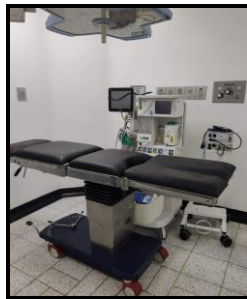
Imagen 36: Fotografías Mantenimiento gases medicinales.
