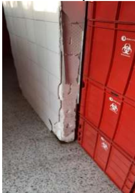
Ilustración 14. Daño en paredes del cuarto de acopio de residuos peligrosos y sin mediacaña
