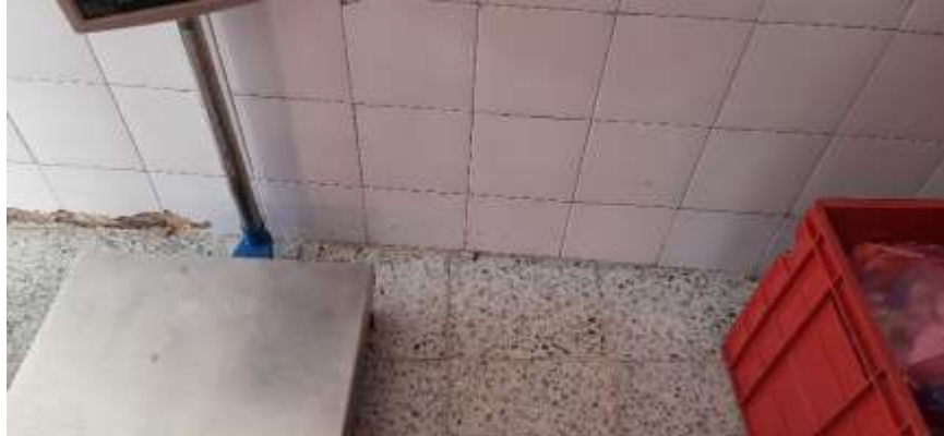
Ilustración 15. Paredes sin media caña.
