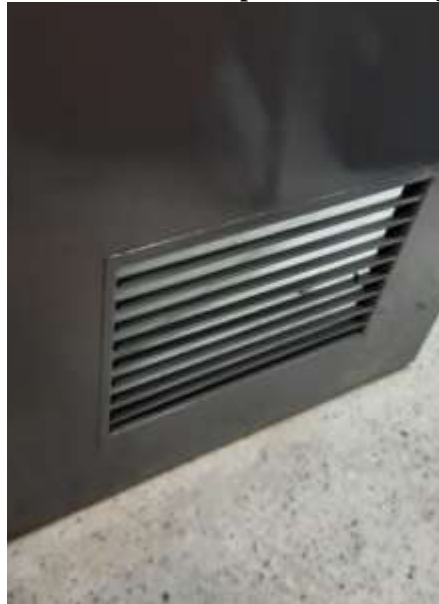
Ilustración 11. Ventilación acopio intermedio segundo piso
