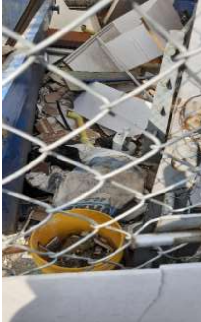
Ilustración 4. Acopio de RCD sin clasificación
