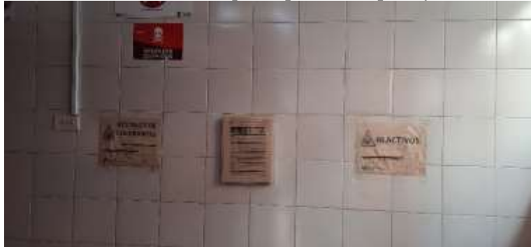
Ilustración 13. Señalización que no permite limpieza y desinfección.
