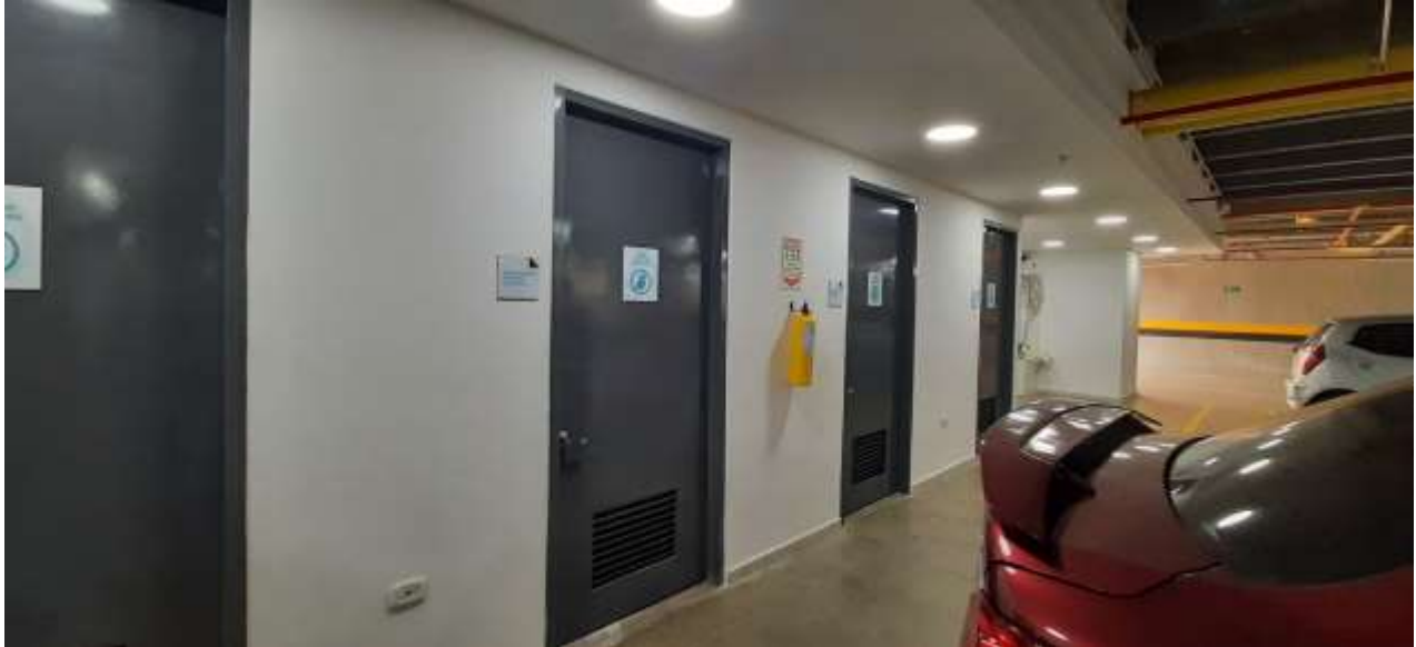
Ilustración 17. Almacenamiento de residuos peligrosos
