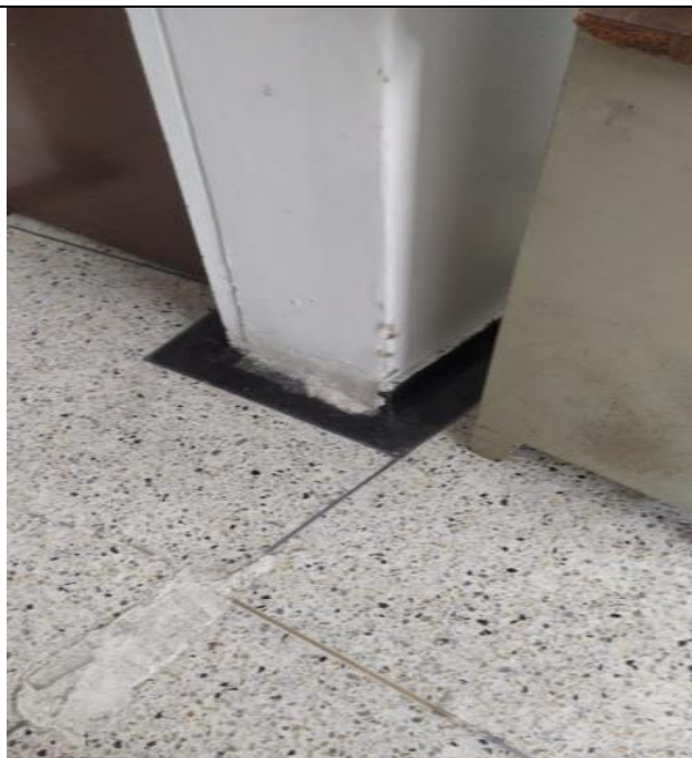
Estado de pisos y paredes consultorio de enfermería – gestantes
