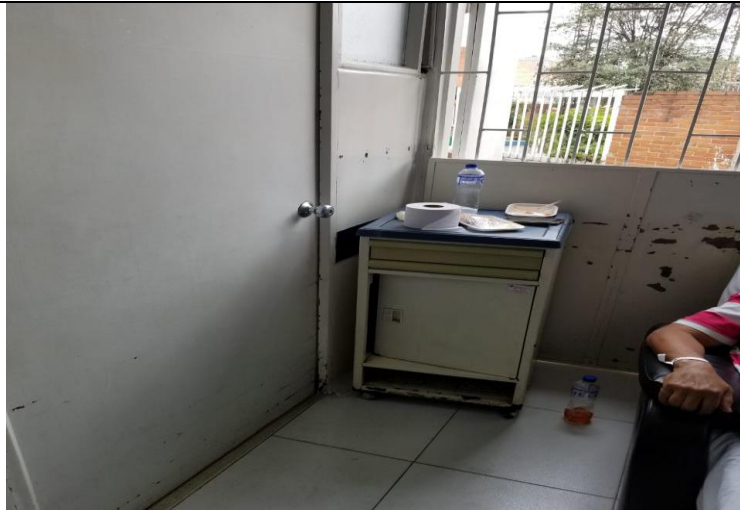
Área de urgencias con elementos deteriorados – restos de comida en el piso de la habitación.
