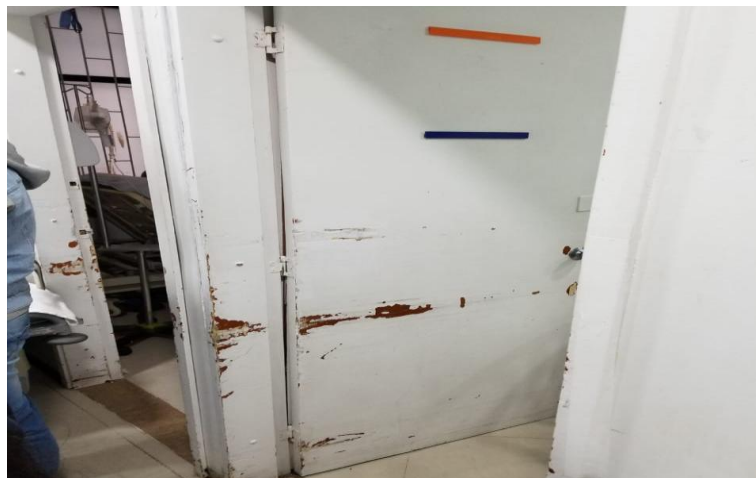
Deterioro en la infraestructura.
